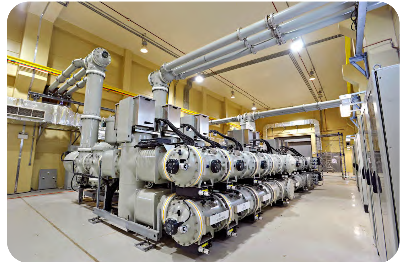
Ilustración 13. Subestación tipo GIS y Subestación AIS.
