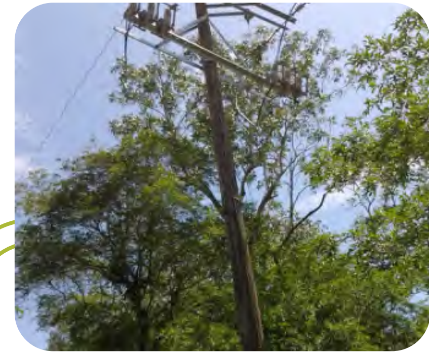
Ilustración 2. Estructura en poste con cortacircuitos triple disparo.
