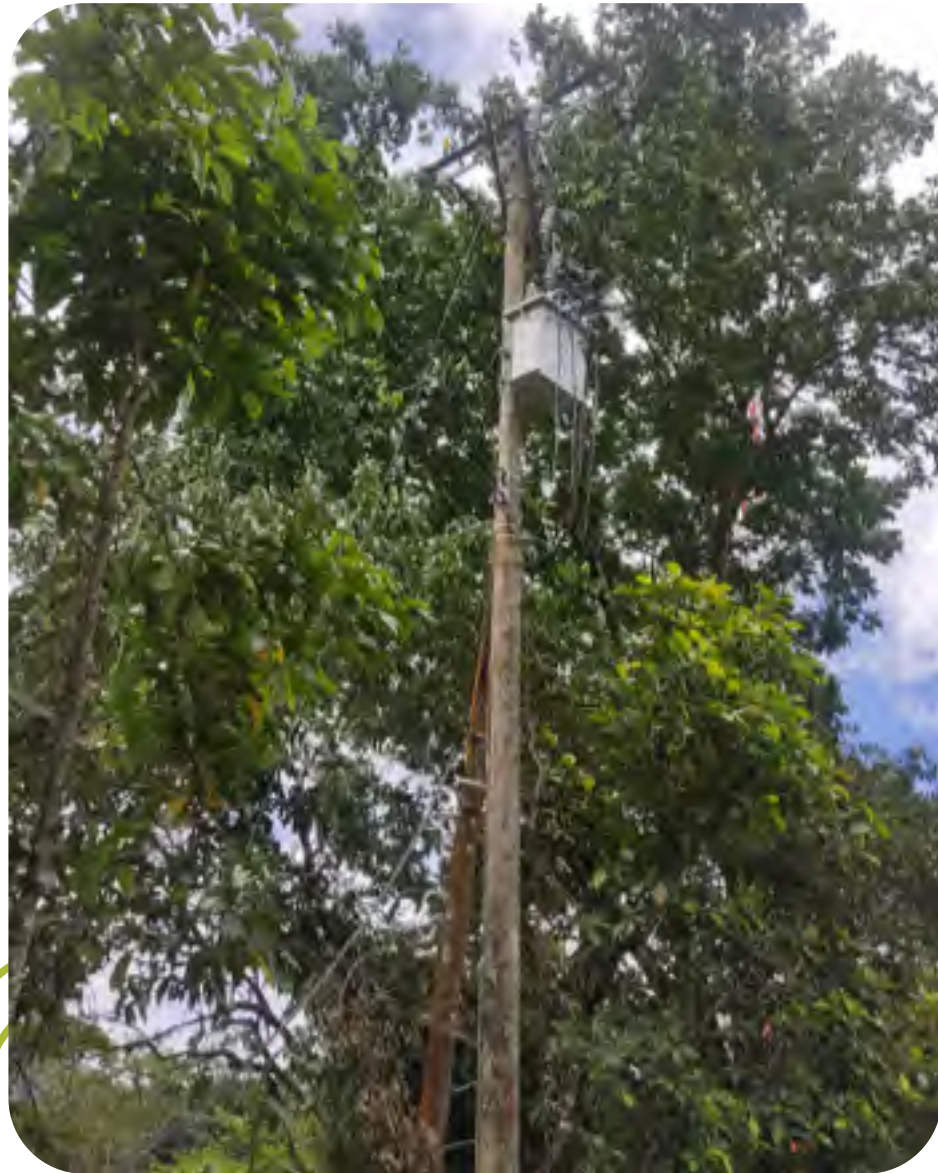
Ilustración 4. Normalización de transformador.
