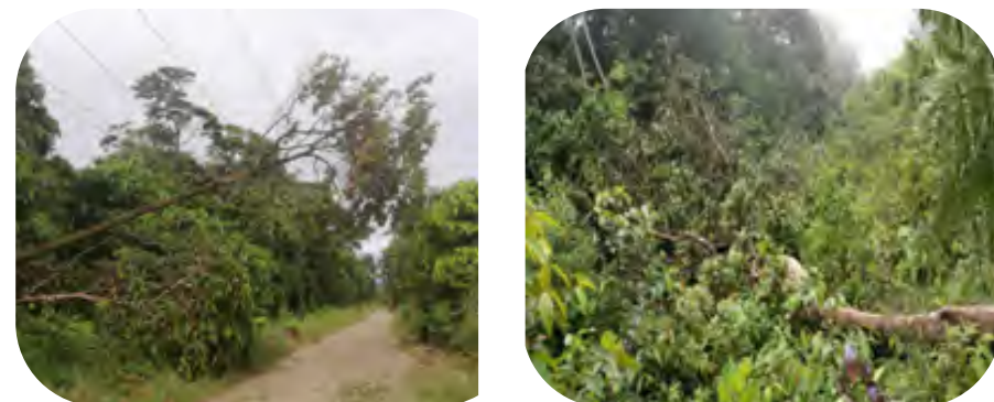
Ilustración 6. Eventos de caída de árboles sobre SDL.
